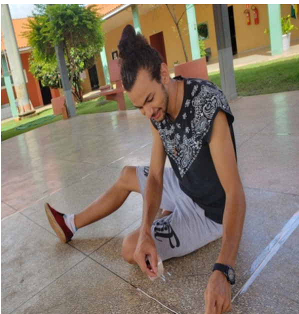
Figura 4 – Demarcação da quadra tátil
