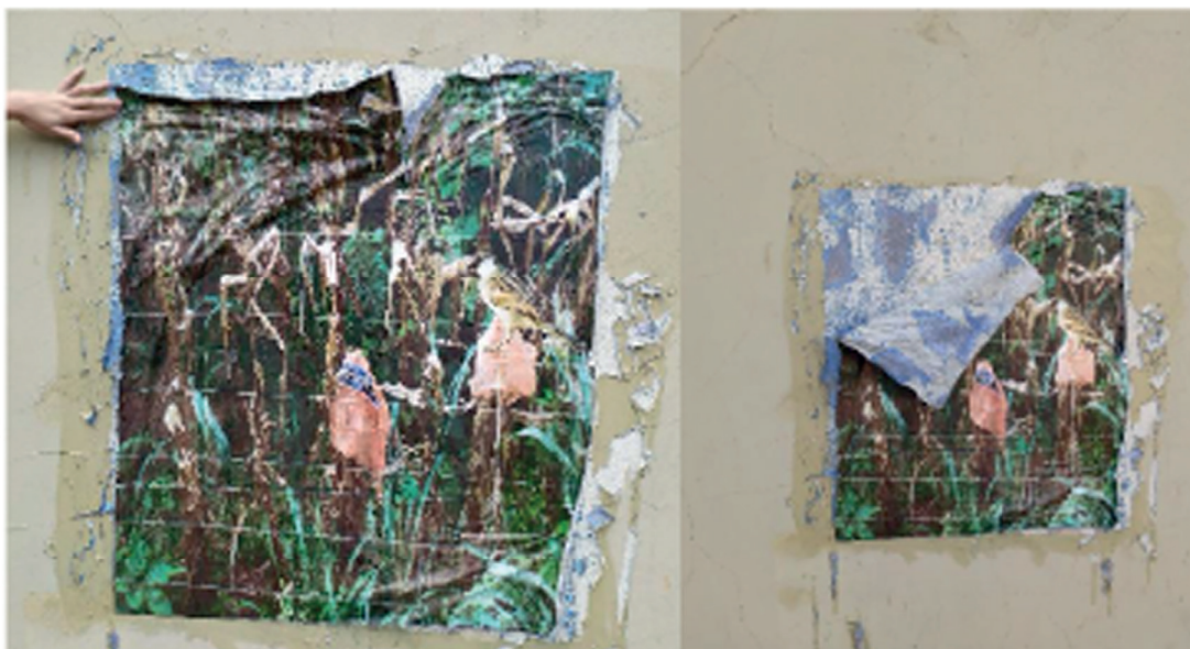
Imagem 3 – Rachaduras e fissuras abertas pelo lambe-lambe na parede.
